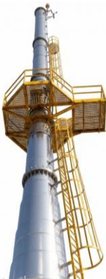
CHIMENEA DE CALDERAS
