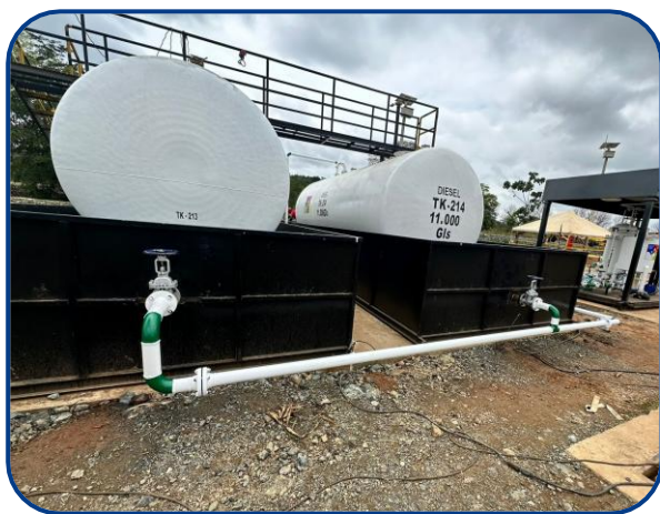
ESTACION DE SUMINSITRO COMBUSTIBLE
